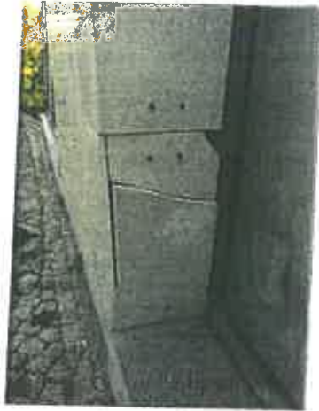
Revestimento em pedra danificado junto ao portão do fundo de palco do pequeno auditório (2.29)
