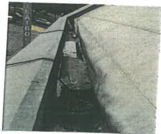
Estado de deterioração dos ralos de drenagem de águas pluviais da cobertura do pequeno auditório
