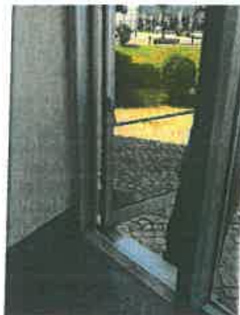
Deficiente funcionamento do mecanismo de abertura/fecho da porta exterior da caixa de escadas do pequeno auditório (2.31)
