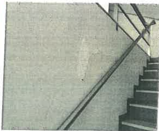
Fissuração e descolamento na parede da escada de ligação entre o acesso ao balcão (2.17) e o foyer (3.01) no grande
