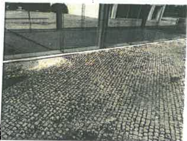
Drenagem deficiente na praça cênica (3.E1) devido à irregularidade das pendentes no pavimento e entupimento dos órgãos de drenagem
