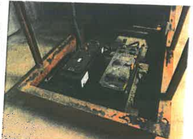
Estado de degradação das baterias da central supressora de incêndio
