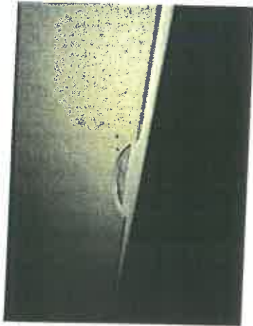
Revestimento em pedra danificado no bar do grande auditório (2.14)
