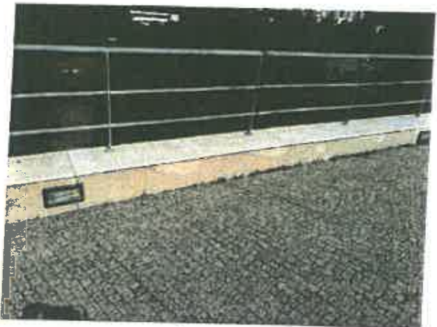
Revestimento em pedra dos muretes danificados junto à praça cénica (3.E1)
