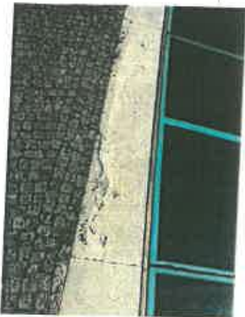
Soleira de pedra danificada junto à claraboia da praça cénica (3.E1)
