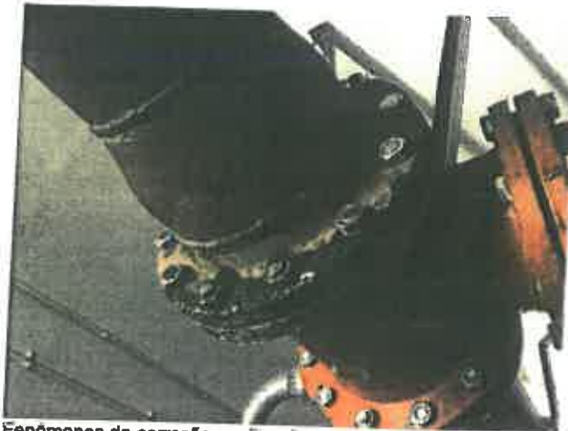
Fenômenos de corrosão em ligações
