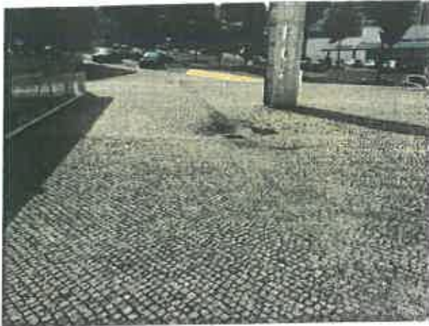
Assentamento do pavimento na praça cénica (3.E1) no tardo dos muros de suporte
