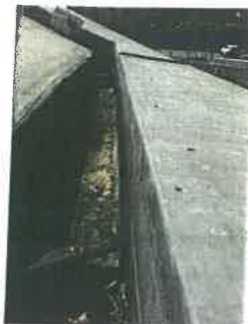
Caleira da cobertura do grande auditório em estado de manutenção deficiente
