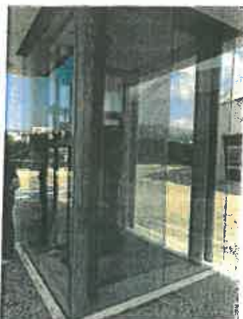
Envidraçado do elevador danificado (3.E1)
