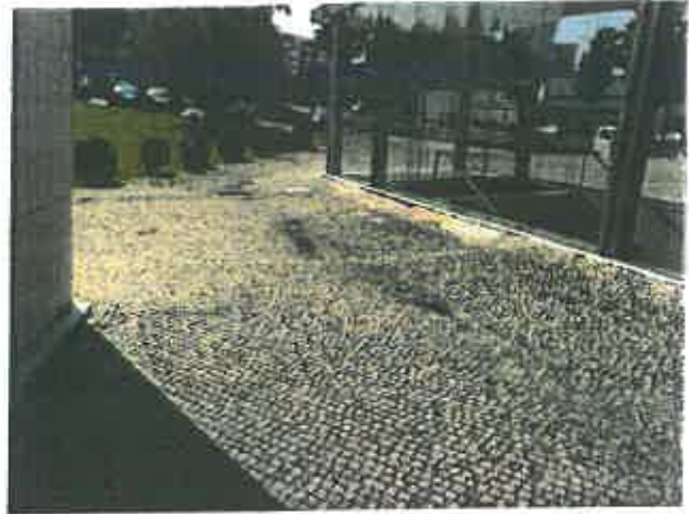
Assentamento do pavimento na praça cénica (3.E1) no tardo dos muros de suporte
