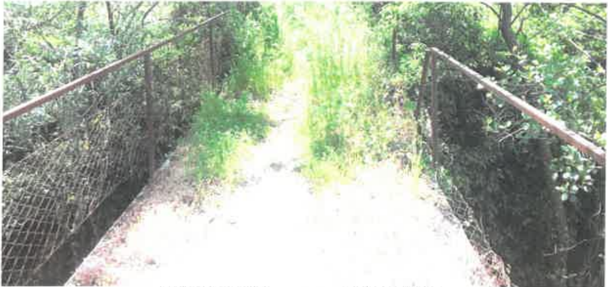
Figura 12: Guardas metálicas da ponte a reabilitar
