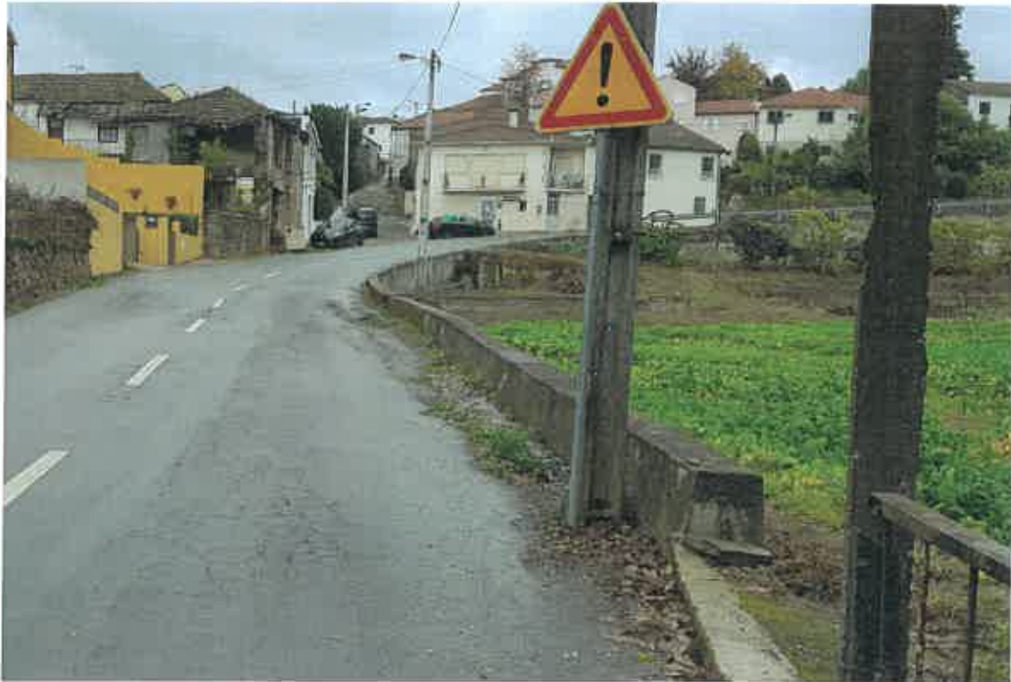
Fig. 8 e 9 – Muro a reconstruir devido a instabilidade causada pela presença de água
