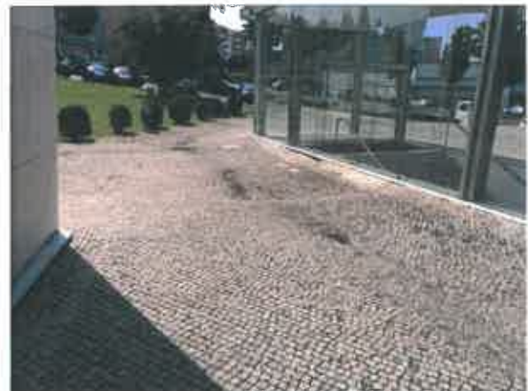
Assentamento do pavimento na praça cénica (3.E1) no tardo dos muros de suporte
