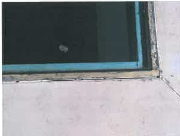
Deficiente selagem da claraboia na praça cénica (3.E1)
