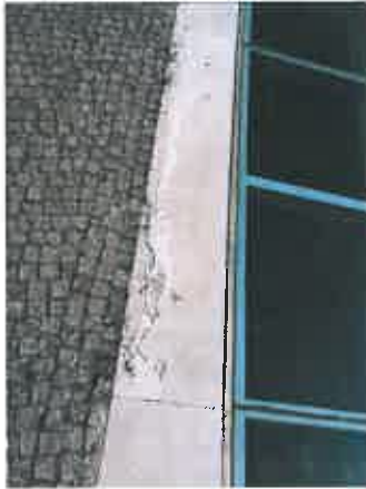
Soleira de pedra danificada junto à claraboia da praça cénica (3.E1)
