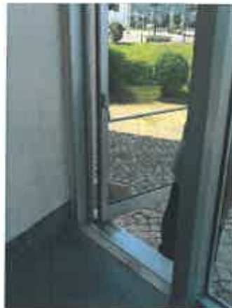
Deficiente funcionamento do mecanismo de abertura/fecho da porta exterior da caixa de escadas do pequeno auditório (2.31)
