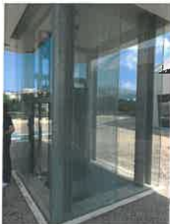
Envidraçamento do elevador danificado (3.E1)
