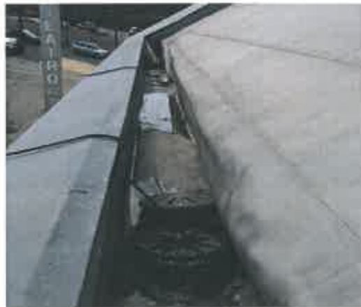
Estado de deterioração dos ralos de drenagem de águas pluviais da cobertura do pequeno auditório
