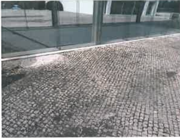
Drenagem deficiente na praça cênica (3.E1) devido à irregularidade das pendentes no pavimento e entupimento dos órgãos de drenagem
