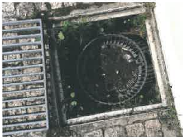
Ralos de drenagem de águas pluviais da praça cênica obstruídos
