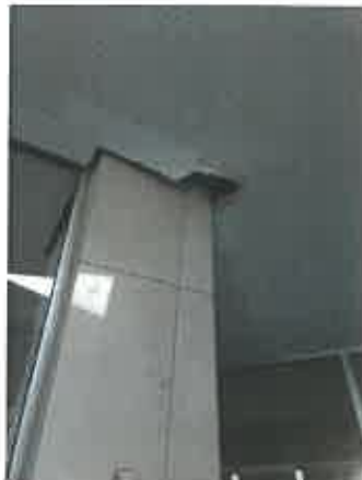
Teto falso danificado no átrio (2.18) devido à infiltração de água da cobertura do pequeno auditório
