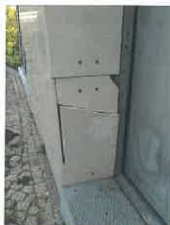
Revestimento em pedra danificado junto ao portão do fundo de palco do pequeno auditório (2.29)
