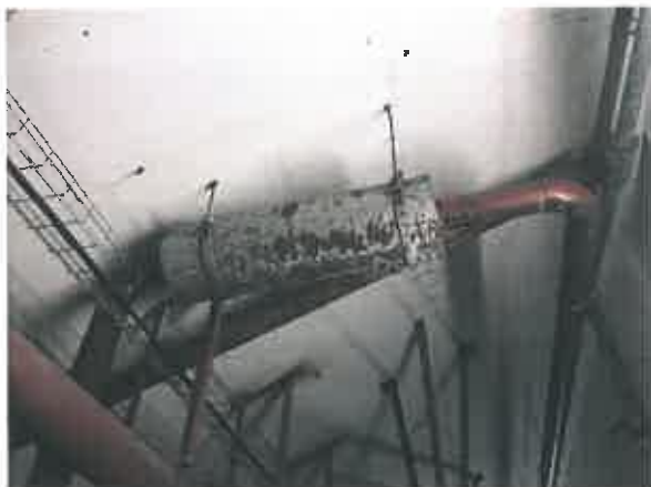
Corrosão nos componentes da central supressora de incêndio
