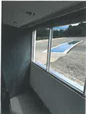
Teto falso danificado junto ao envidraçado da saída de emergência/fim de espetáculo (3.13) devido à infiltração de água da cobertura do pequeno auditório
