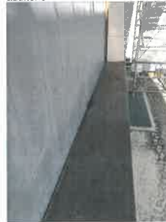
Deficiente funcionamento na abertura/fecho do portão do palco do auditório exterior (2.03)
