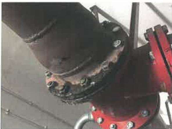
Fenômenos de corrosão em ligações
