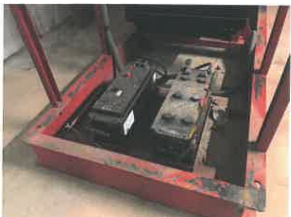
Estado de degradação das baterias da central supressora de incêndio
