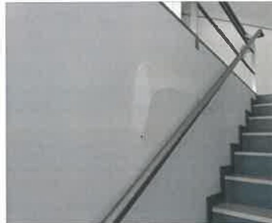
Fissuração e descolamento na parede da escada de ligação entre o acesso ao balcão (2.17) e o foyer (3.01) no grande auditório
