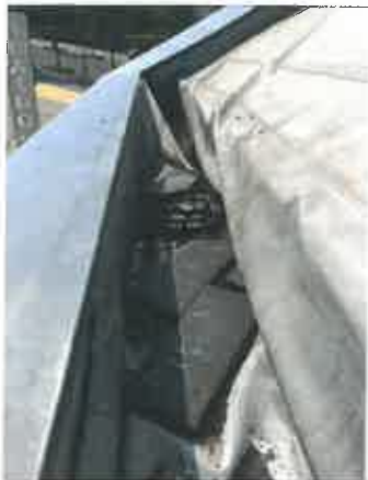
Tela da cobertura do pequeno auditório em estado de conservação e manutenção deficiente junto aos rufos laterais, órgãos de drenagem e caleira
