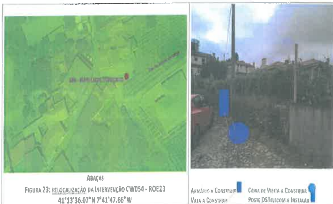
Imagem 22 – Aباças – Intervenção CW054 – ROE23: Colocação de armário de distribuição de fibra ótica, construção de caixa de visita permanente, tudo pertencente à Derivadas e Segmentos, SA., abertura e fecho de valas de interligação entre a caixa de visita a construir, o armário a colocar e poste EDP existente, bem como a passagem de cabo em infraestruturas existentes.
