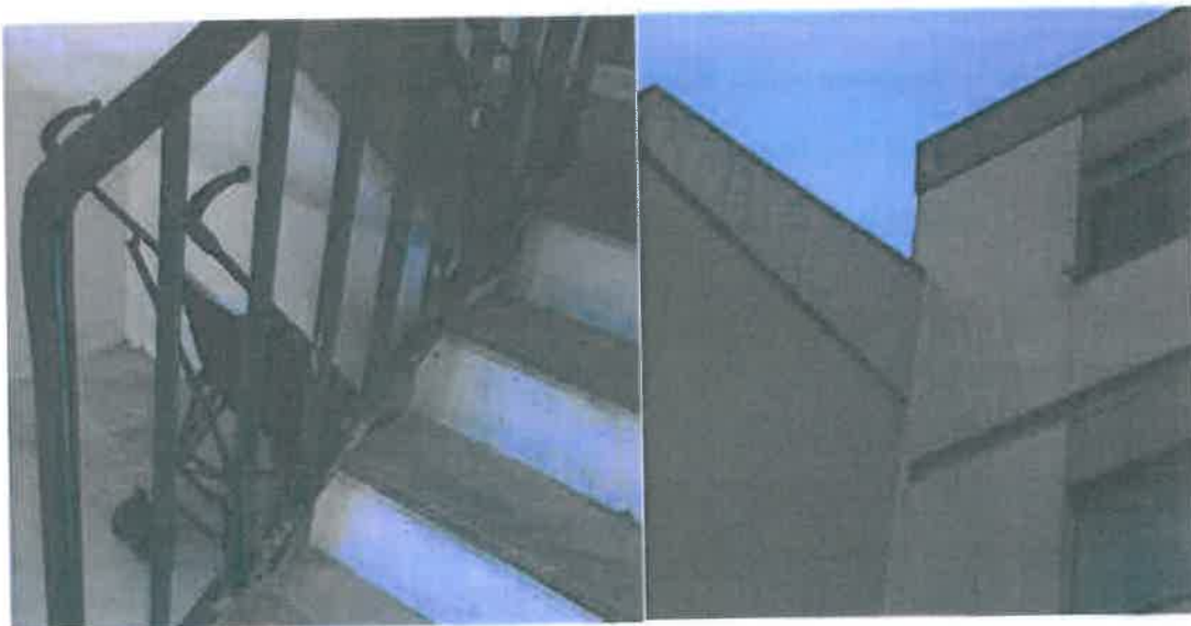
Figura 9 - Exemplo do levantamento de anomalias realizado em partes comuns e em edifícios de Bairros Sociais corretivas que urge realizar para a manutenção de edifícios e para a obtenção do maior conforto dos seus utentes.
