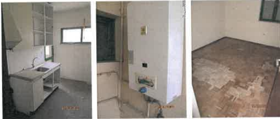
Móvel de cozinha danificado, esquentador obsoleto, parquet incompleto
