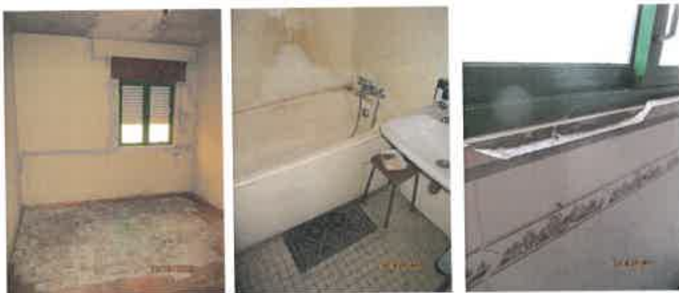
Fissuração em paredes exteriores, banheira danificada e instalação sanitária sem azulejo, peitoril danificado
