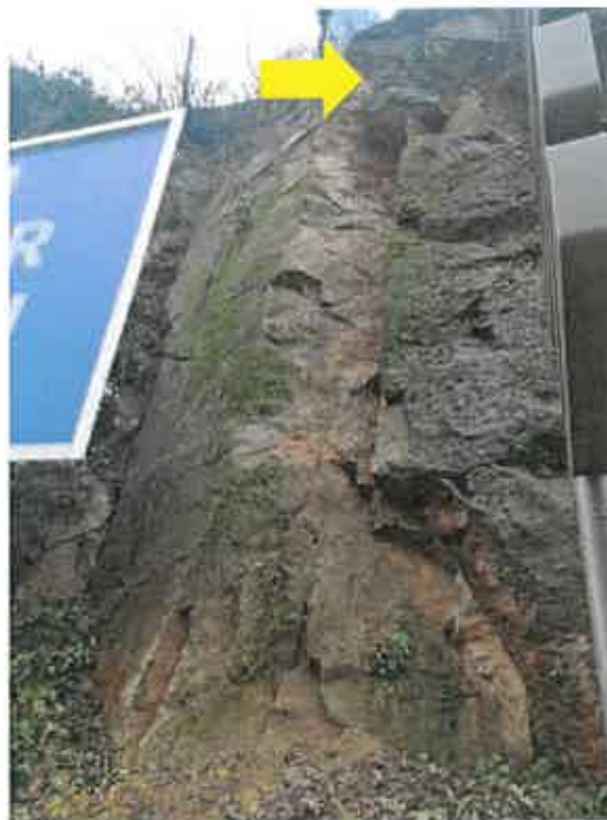
Fotografia 2 – Idem, com pormenor de bloco rochoso suspenso no topo da cicatriz de escorregamento, suportado por outro bloco rochoso (Geovia, 22 de dezembro de 2022).
