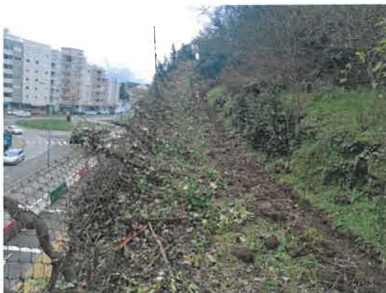
Fotografia 6 – Vista geral do topo do talude de escavação no local do escorregamento – acesso facultado gentilmente pelo proprietário do terreno com o apoio da CMVR – (Geovia, 22 de dezembro de 2022).
