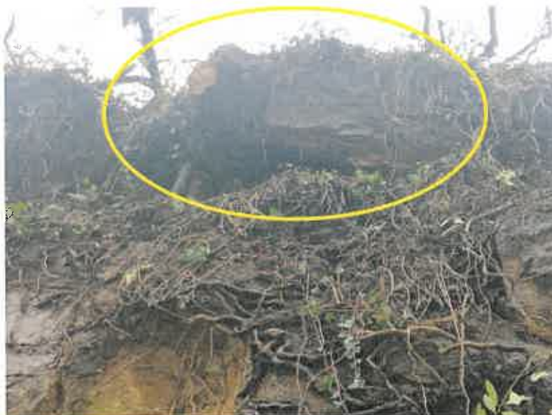
Fotografia 3 – Pormenor de bloco rochoso suspenso, no topo do talude de escavação, suportado por uma raiz de pinheiro (Geovia, 22 de dezembro de 2022).
