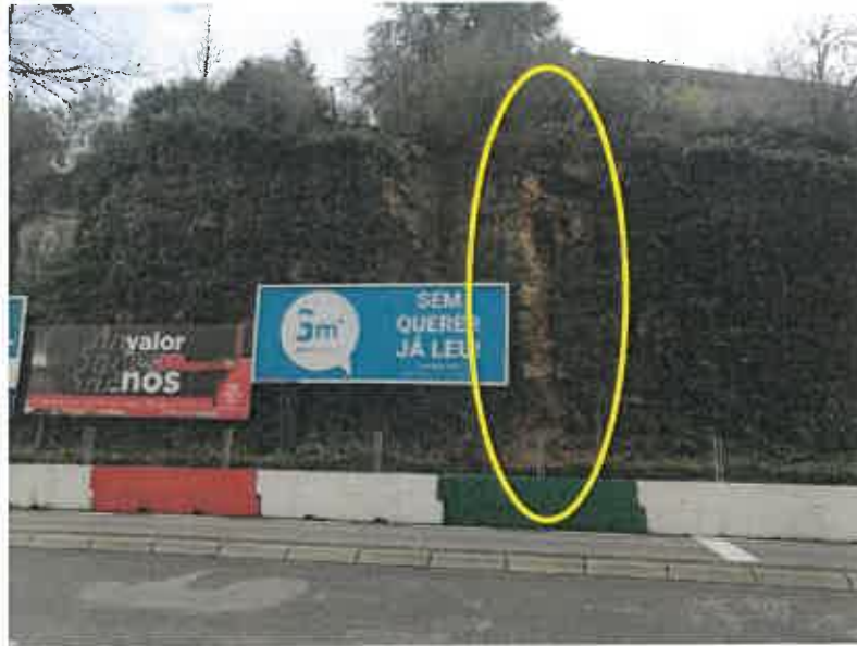
Fotografia 1 – Vista geral da cicatriz da cunha de escorregamento do talude de escavação que afetou toda a altura do talude (Geovia, 22 de dezembro de 2022).
