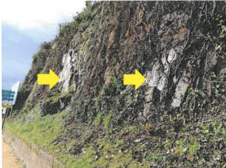
Fotografia 7 – Evidências de percolação de água patentes em vários locais na face do talude de escavação (Geovia, 22 de dezembro de 2022)
