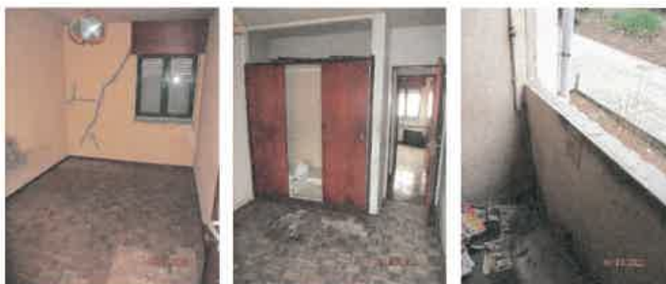
Fissuração em paredes exteriores, roupeiros danificados, inexistência de janela em lavandaria
