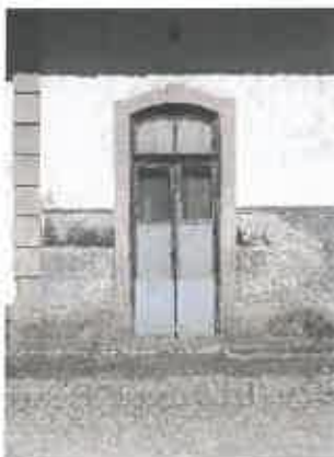
10 Portas acesso estação (em madeira, a recuperar)
